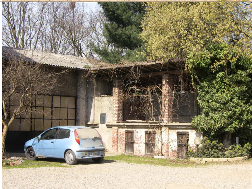
Gli accessori rurali esistenti: si noti la copertura non compatibile in lastre ondulate
